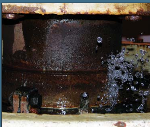
Läckage korroderar utrustningen och ger snabb förslitning av lagren
