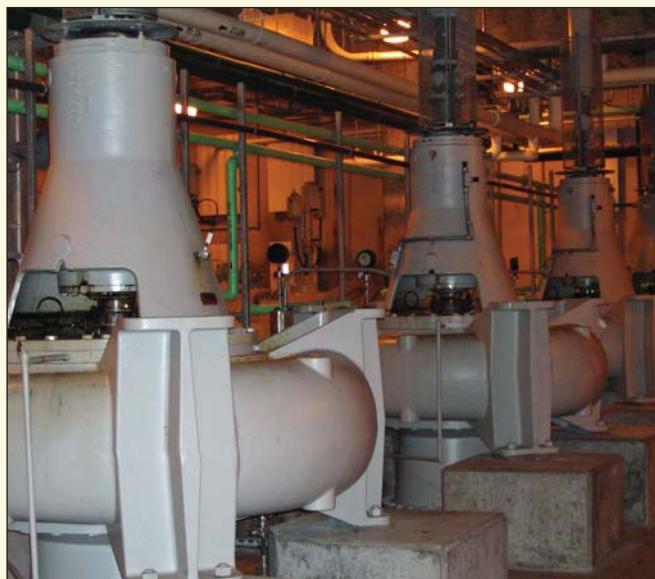
Avloppsvattenpumparna ovan använder delade tätningar med 200 mm diameter och har varit i drift i mer än 12 år.
